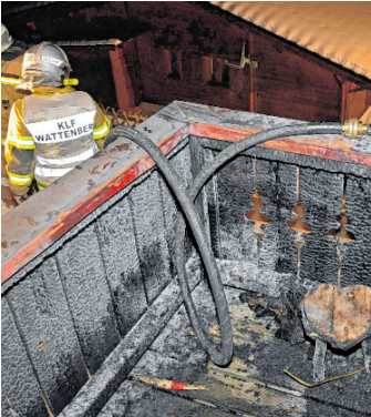
In Wattenberg wurde dieser Balkon durch ein Feuer zerstört.
